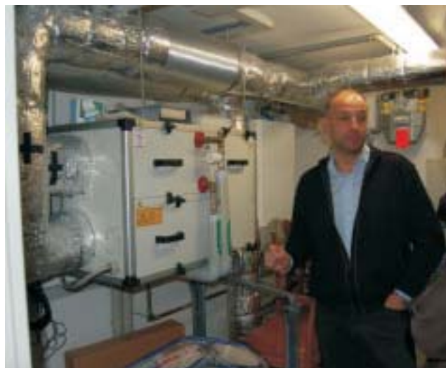
Ulrich Frank vysvětluje systém rekuperační jednotky v domě v pozadí je technika pro ohřev plynem, která se zapíná v případě potřeby
